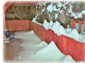
(写真13) 小屋内への雪吹込み状況
