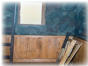
(写真11) 冬期出入口扉破損状況
